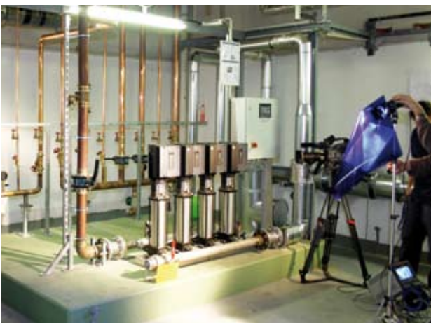
Neue Druckerhöhungsanlage mit vier Grundfos-Pumpen zur hygienischen Trinkwasserversorgung der MNR-Klinik des Düsseldorfer Universitäts-Krankenhauses. Die Sanierung war selbst für die elektronischen Medien ein Thema.
