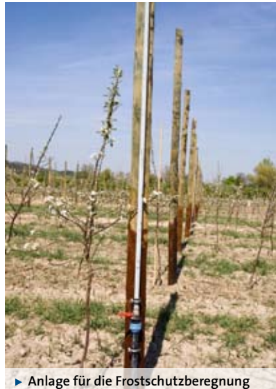
► Anlage für die Frostschutzberegnung
