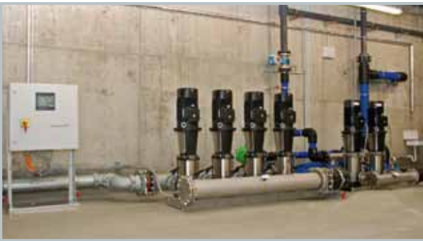
Zwei Grundfos Hydro MPC Druckerhöhungsanlagen mit benutzerfreundlicher Bedienung sorgen für ausreichenden Wasserdruck für Außenhydranten und Nachspeisung der Kühltürme
