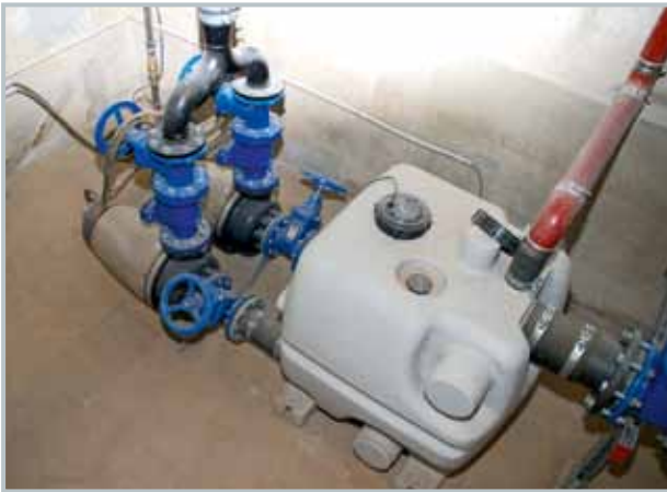
Die in der Abwasserschächten des LOOP5 eingesetzten Grundfos Hebeanlagen vom Typ MDV mit 400-Liter-Sammelbehälter erlauben einen Dauerbetrieb über die gesamte Kennlinie und stellen auch bei großen Zulaufmengen eine zuverlässige Entwässerung sicher
