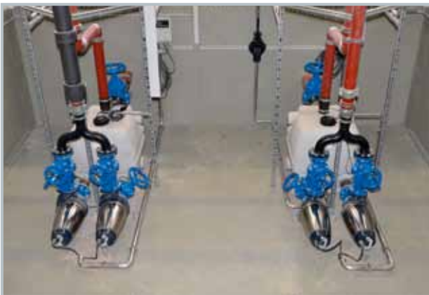
Abwasser unter der Rückstauenebene und Niederschlagswasser aus Innenhöfen wird mit Grundfos Doppelpumpen-Hebeanlagen der Serie MDV entwässert.
