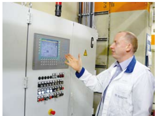
Bei Pumpen mit einer Leistung über 22 kW offeriert Grundfos externe Frequenzumformer der Baureihe CUE; Nils-Stefan Bang von der Werkplanung Salzgitter erläutert anhand des Displays am Steuerschrank die Funktion der installierten Kühlschmierstoff-Versorgungspumpen.
