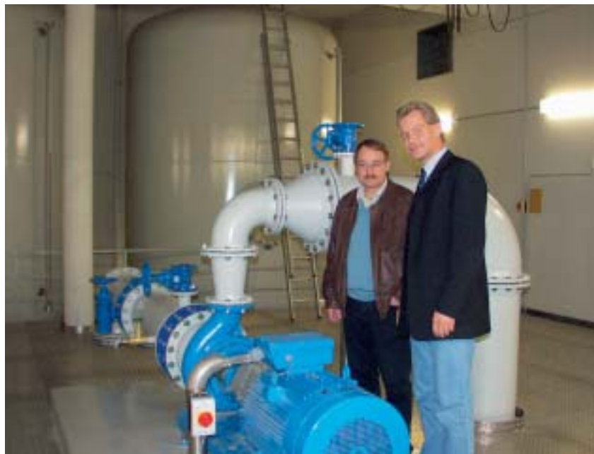
Das stets aktive Netz-Aggregat ist drehzahlsteuerbar ausgelegt, die beiden anderen Pumpen werden im Bedarfsfall mit voller Leistung zugeschaltet. (li. Gerhard Weisgerber, Aggerverband; re. Volker Zimmermann, Grundfos)
