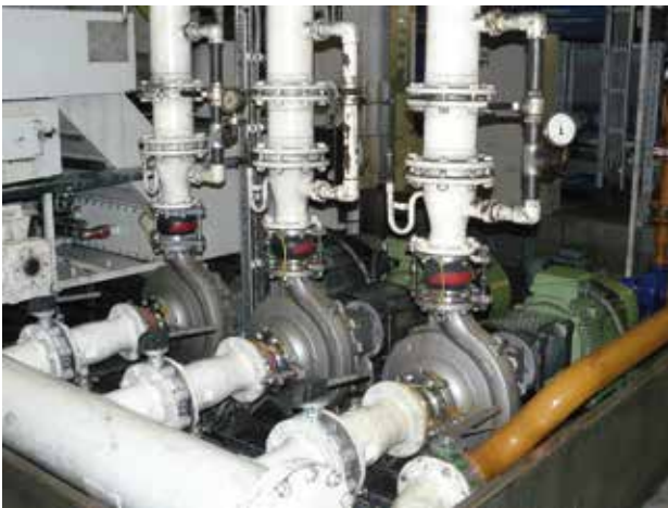
Diese drei KSS-Pumpen standen beim Pump Audit-Pilotprojekt im Mittelpunkt des Interesses – aufgrund der Wirtschaftlichkeit bleiben sie weiter in Betrieb.
