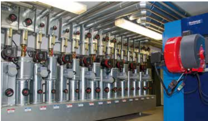
Die neue Wärmeverteilung des Zweirohr-Systems wurde ausschließlich mit Grundfos-Hocheffizienzpumpen der Baureihe Magna3 realisiert (Foto: Grundfos).
