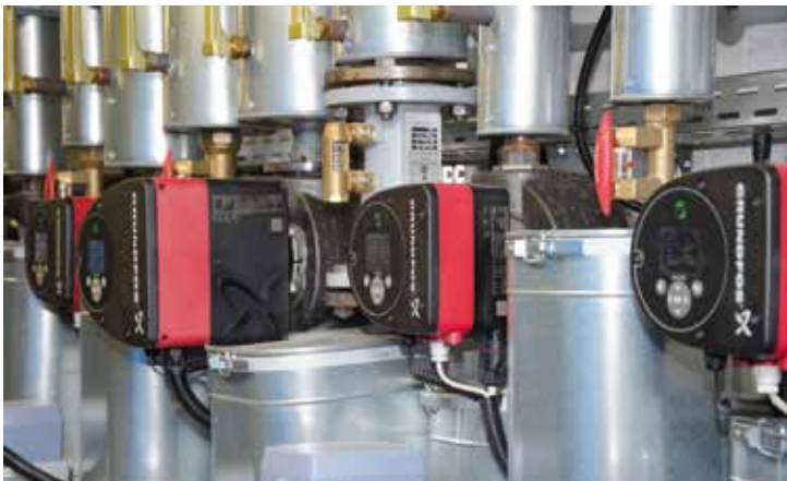
Mit über 200 Ausführungen ist die Magna3 die vielseitigste Nassläufer-Baureihe am Markt – in Duisburg wurden die Baugrößen Magna3 25-60, 25-100, 32-40, 32-100 und 32-120F installiert (Foto: Grundfos).
