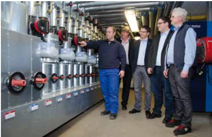
Hendrick Verweyen, Uwe Mallmann, Raimund Sauer von Grundfos, Dominik Mallmann und Fachbereichsleiter Wolfgang Holtwick (v.l.n.r.) begutachten die Grundfos-Pumpen in der neuen Heizungszentrale (Foto: Grundfos).
