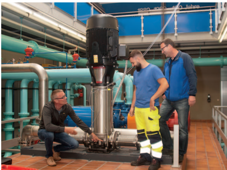
Die CRN 125 – 6 im Feldversuch nach der Montage. Personen von links nach rechts: Patrick Link-Walter, Außendienstmitarbeiter Wasserwirtschaft Grundfos GmbH Tobias Grumbach, Anlagenmechaniker Albstadtwerke GmbH Hans-Peter Fuß, Projektleiter Albstadtwerke GmbH
