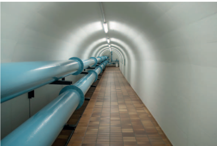
Kaverne 2 ist einer von drei Hochbehältern. Die Verrohrung dient zur Förderung in die beiden 3.000 m 3 fassenden Speicherbecken sowie der Einspeisung in das Versorgungssystem der Stadt
