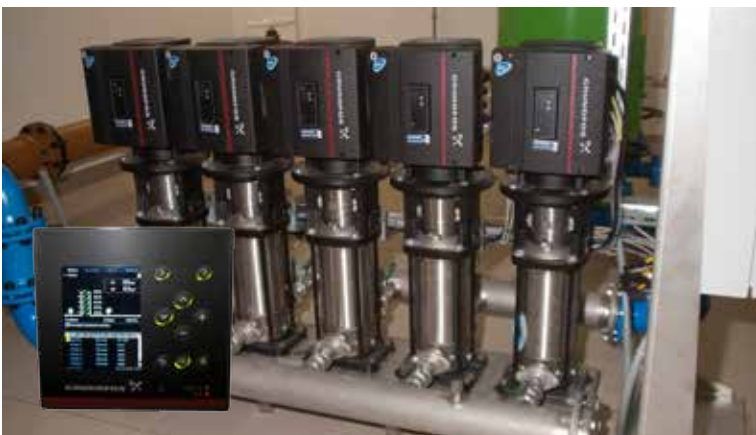
Nach dem Austausch der Pumpentechnik im GPW Wolktersham. Die Aufgabe übernimmt eine Hydro MPC-E 5 CRIE 10-9. Steuereinheit CU354: alle relevanten Daten stehen auf dem Display zur Verfügung.
