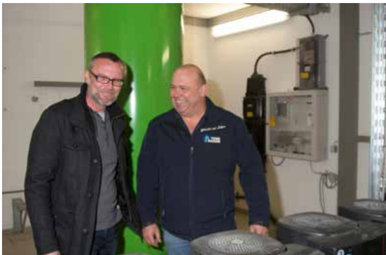
Anlage in Wolkertsham, links: Patrick Link-Walter, Außendienstmitarbeiter Wasserwirtschaft Grundfos rechts: Roland Kainz, Wassermeister, ZV Wasserversorgung Rottal
