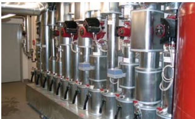
Blick in die Heizzentrale mit drehzahlgeregelten Heizungsumwälzpumpen von Grundfos (UPE 2000 und Magna).
