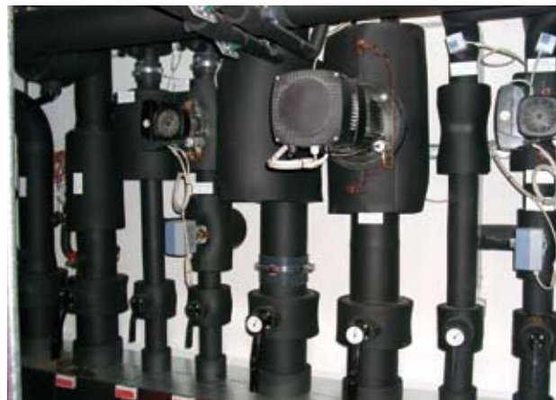
Drehzahlgeregelte TPE-Pumpen im Kühlkreislauf.
