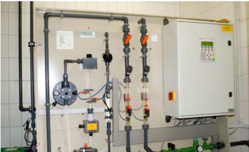
▶ Vollautomatische Chlordioxidanlage Oxiperm 166 nach dem Chlorgas / Natriumchlorit-Verfahren
