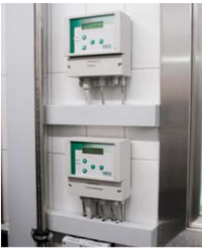
▶ Gaswarngeräte - das Gas wird separat gelagert
