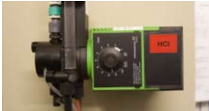
► DMI Dosierpumpe für die Zugabe von Salzsäure (unten) sowie eine DMI Dosierpumpe für die Zugabe von Natriumchlorit
