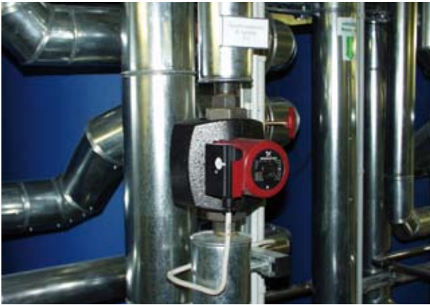
Heizungs-Anlage mit GRUNDFOS MAGNA
