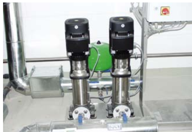
Auch im VE-Wasser-Kreislauf arbeiten Hochdruckpumpen der Baureihe CR.
