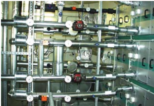
Heizungs-Anlage mit GRUNDFOS MAGNA
