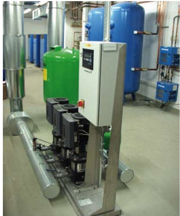
Alle Pumpen für die SHK-Gewerke stammen aus dem Hause GRUNDFOS. Installiert sind u.a. zwei Druckerhöhungsanlagen HYDRO 2000 ...
