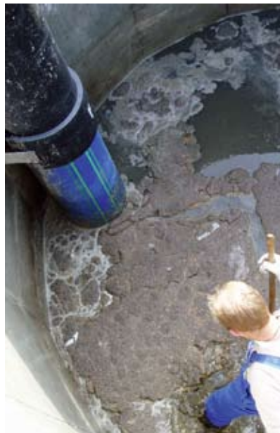
▶ Ausgleichsbehälter der Kläranlage Schafflund. Endpunkt der Abwasserdruckleitung aus Medelby
