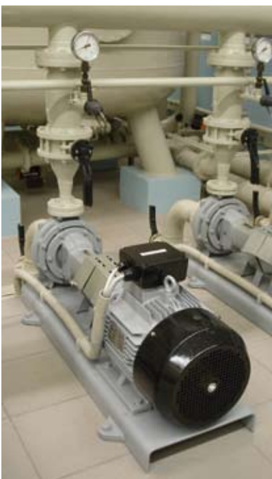
► Grundfos Normpumpen mit 5 x 15 kW bzw. 4 x 30 kW im Wasserwerk Treskow und Wasserwerk II
