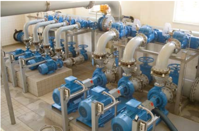
► Gesamtanlage mit der Pumpentechnik auf einen Blick
