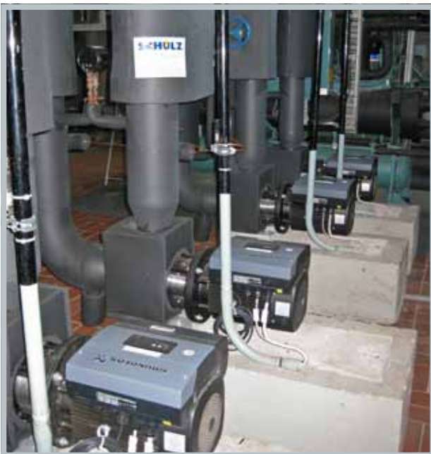
Geregelte Blockpumpen vom Typ Grundfos NBE mit integriertem Frequenzumrichter im Kälterücklauf: Nennweite DN 50 statt DN 65/DN 80 (Bildquelle: Grundfos/Schulz Versorgungstechnik)
