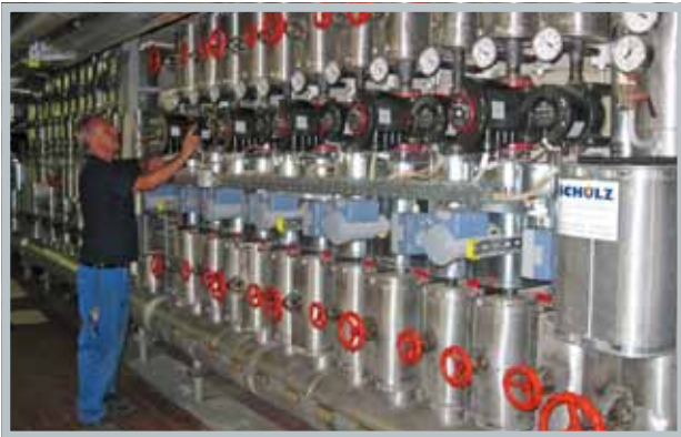
Kleinere Dimensionierung nach Messungen an der Anlage: Heizkreis-Verteiler mit Hocheffizienzpumpen vom Typ Grundfos MAGNA (Bildquelle: Grundfos/Schulz Versorgungstechnik)
