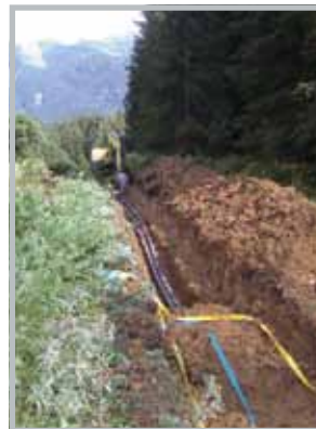
Getrennte Leitungen mit unterschiedlichen Nennweiten für Lösch- und Trinkwasserversorgung
