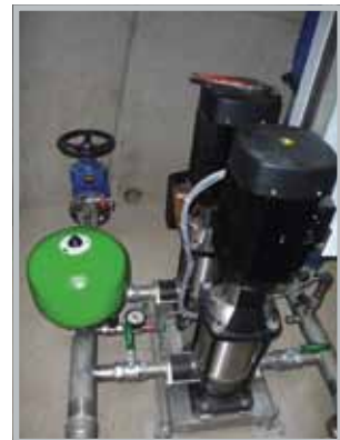
Kompaktdruckerhöhungsanlage Grundfos Hydro MPC mit 2 Pumpen vom Typ CRI 10-7
