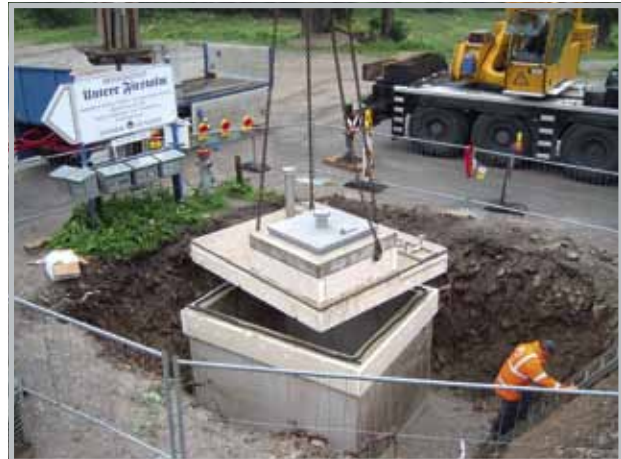
Fertigteilschacht mit Druckerhöhungsanlage im Tal
