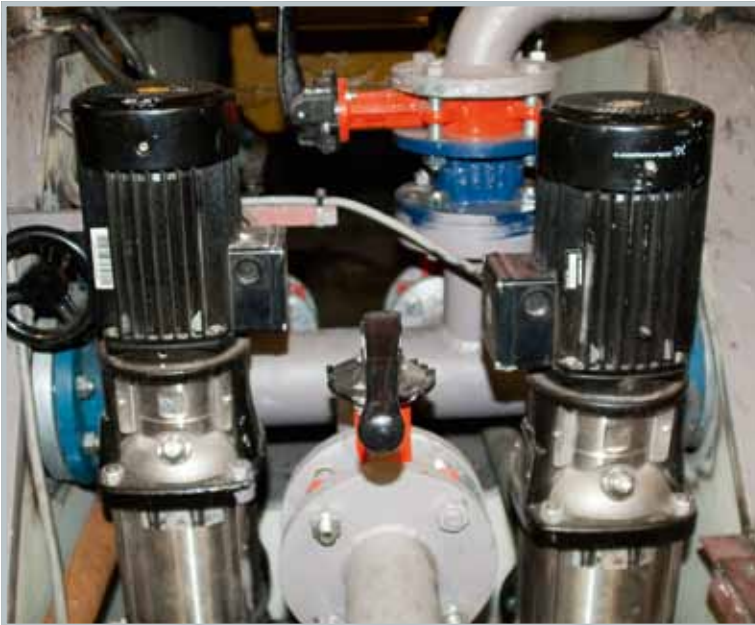
Zwei CRN 20-3 als Feuerlöschpumpe / Sprinkleranlage
