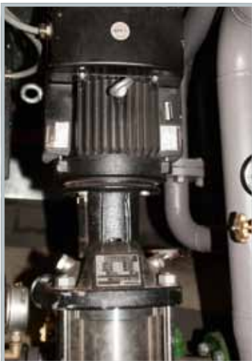
Eine CRN 5-7 als Kühlwasserpumpe für den Generator
