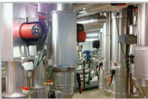
Die drehzahlgeregelten Grundfos MAGNA-Umwälzpumpen in der Heizungsverteilung passen die Pumpenleistung lastabhängig an.
