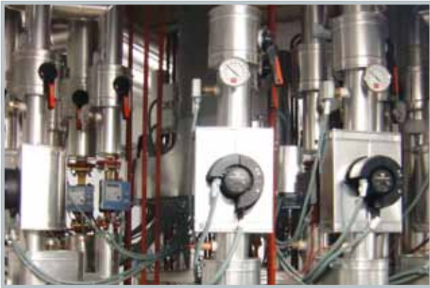
Selbstadaptierende Pumpen und eine hydraulische Entkopplung in der Heizungsverteilung durch das Zortström-Sammel- und Verteilsystem sorgen für die Einhaltung der geforderten Raumtemperaturen in allen Trakten des Krankenhausgebäudes.
