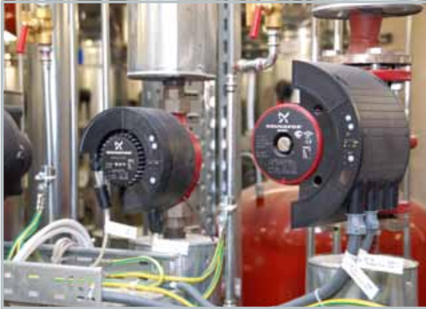
Grundfos Magna Hocheffizienzpumpen in der Heizungszentrale.
