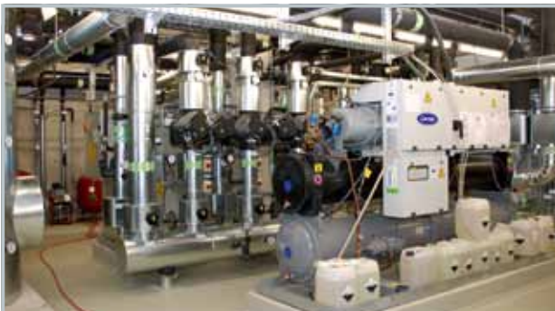
Kältezentrale mit geregelten Grundfos-Inlinepumpen der Baureihe TPE.
