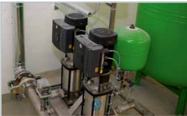
Grundfos-Druckerhöhungsanlage Hydro Multi-E 2 CRIE für die Trinkwasserversorgung in den oberen Geschossen des Hochhauses.
