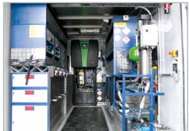
Die Chlordioxid-Erzeugeranlage Oxiperm Pro (Bildmitte, hinten) kann auch bei beengten Raumverhältnissen installiert werden; vorne rechts die Druckerhöhungsanlage CR.
