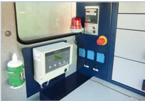
Safety first – Blick auf die Überwachungs- und Alarmanlagen im Hygiene-Mobil.
