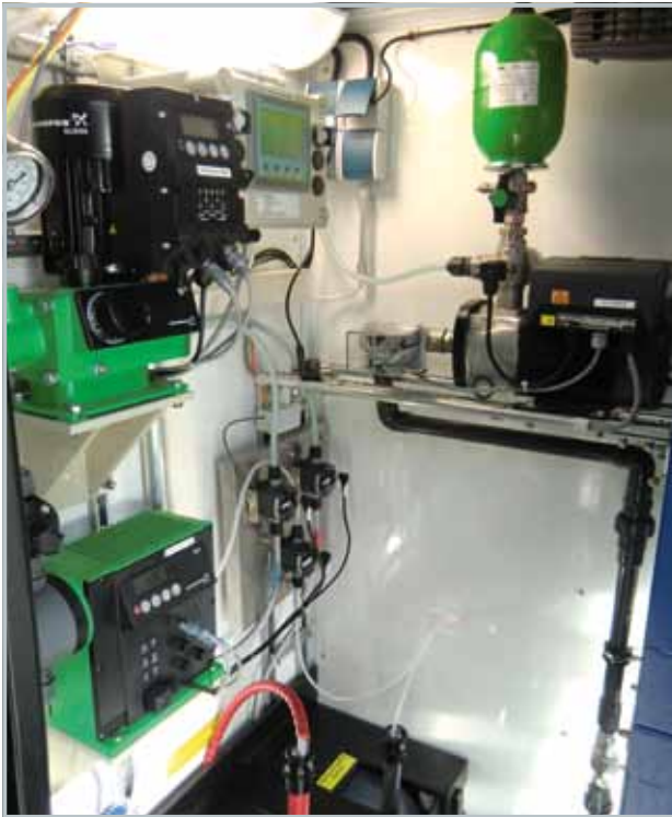
Blick auf die Chemikalienbehälter, die Dosierpumpe mit Schrittmotortechnik und die Kolbenmembranpumpe für Drücke bis 16 bar - Verdünnungswasserpumpe CMBE
