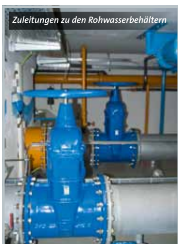
Schaltzentrale Wasserwerk Wasservernad Treene
