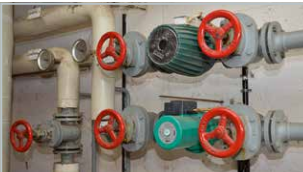
Als Zubringerpumpen für die statische Heizung waren noch ältere unregelte Modelle im Einsatz
