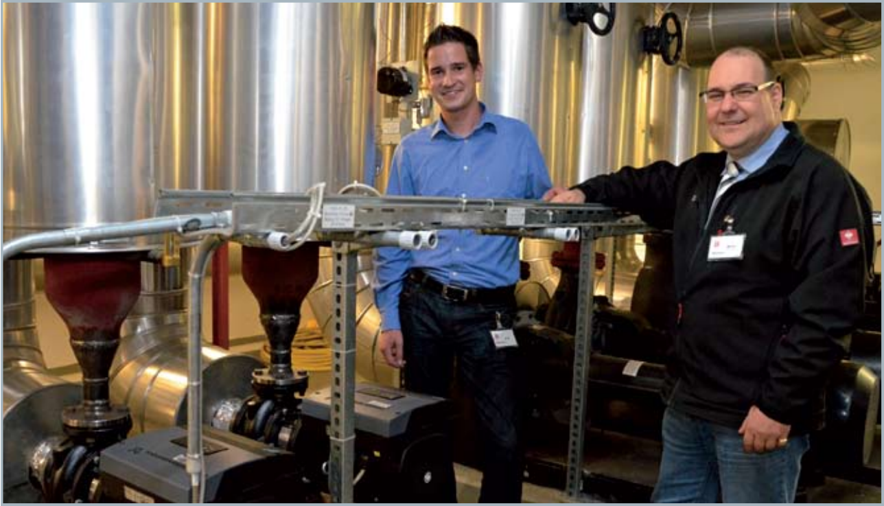
Sascha Barrabas von Grundfos (links) und Gino-Valerio Bruno von Pumpen Binek an der neuen Anlage
