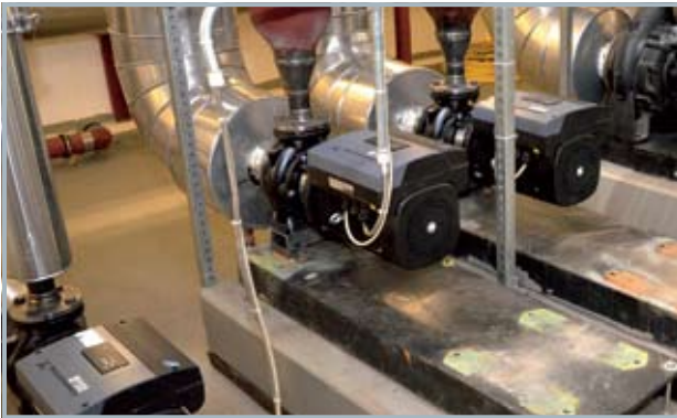
Die neue Anlage mit drei identischen Blockpumpen NBE 50-125/121, von denen zwei mit 20-prozentiger Leistungsreserve die Spitzenlast abdecken
