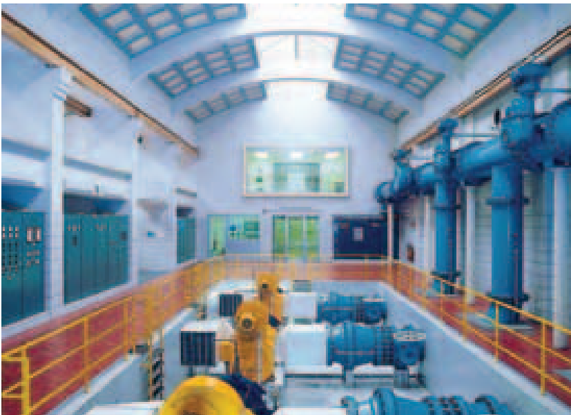
Die Aktivkohlefilteranlage im Wasserwerk Rheinau der MVV Energie AG.
