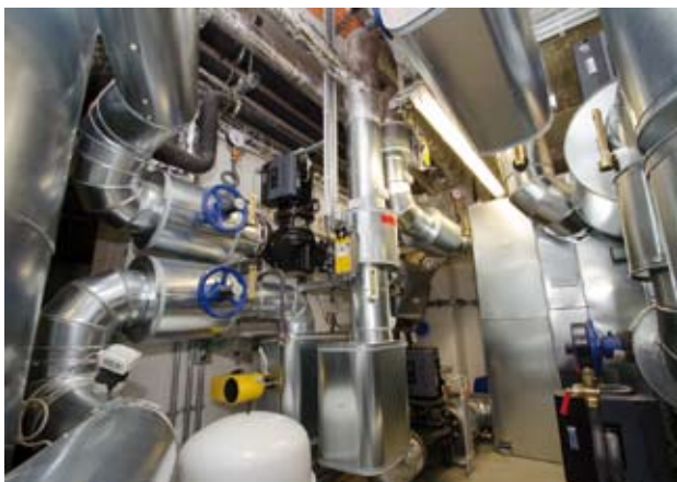
Inline-Pumpen der Grundfos-Baureihe TPE mit werkseitig montiertem Differenzdrucksensor in der Rückkühlung der Kältemaschinen (links) und im Wärmetauscher-Kreis des Erdsondenfeldes (rechts)
