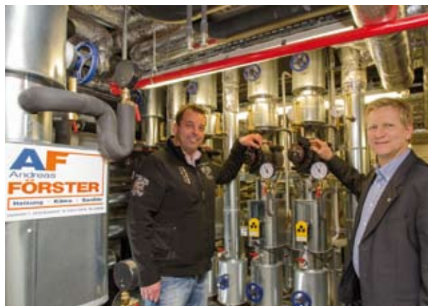
Frank Haverland (Projektleiter Andreas Förster, links) und Thorsten Halpap (Verkaufsleiter Großprojekte Gebäudetechnik Nord bei Grundfos, rechts) stellen ein gewerke-übergreifendes Pumpenkonzept und kurze Wege bei Planung und Umsetzung sicher
