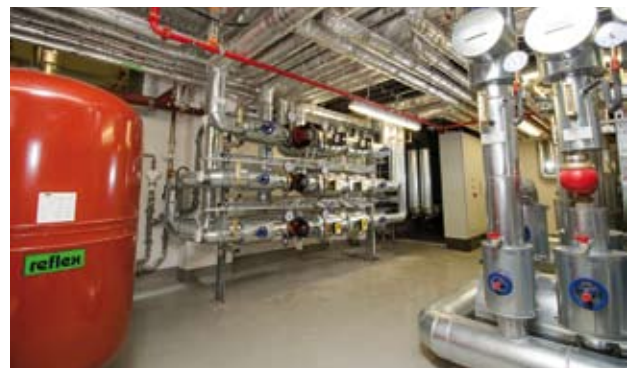
In der neu errichteten Technikzentrale im Untergeschoss des Ostbaus ist ausschließlich Pumpentechnik von Grundfos installiert (hier: Regelgruppe Wärmepumpe/Gebäudeeinspeisung mit Magna-Hocheffizienzpumpen)
