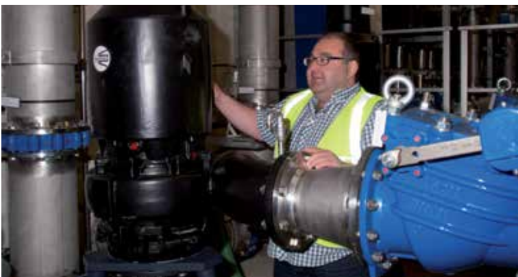
Maik Wötzel, Vertriebsrepräsentant Grundfos, bei der Prüfung der Pumpentechnik.
