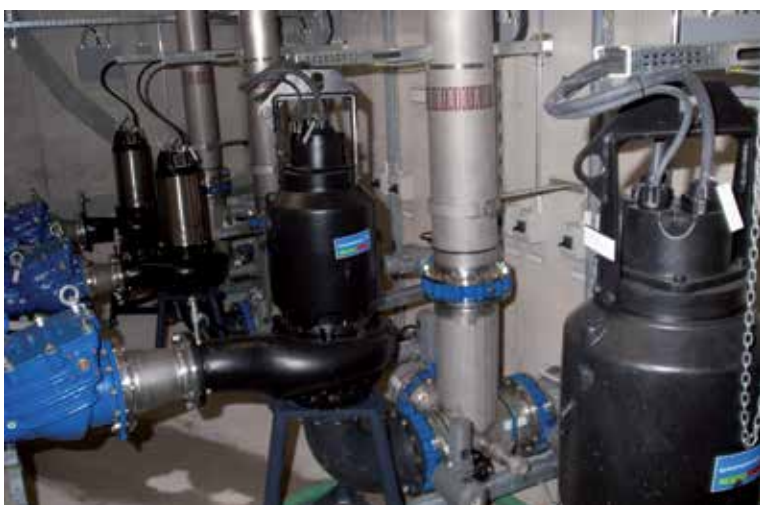
Im Stapelbecken 8 werden zwei S2.100.200.500 und zwei SE1.110.200 eingesetzt. Sie fördern das Oberflächenwasser in die verschiedenen Retentionsbecken bzw. in die Aufkonzentration.
