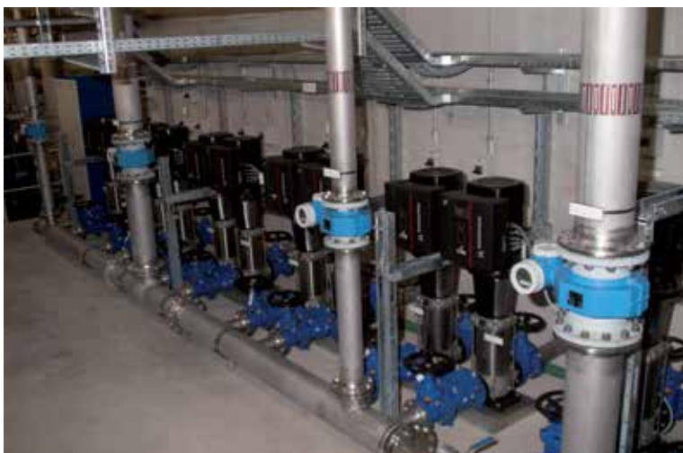
Stapelbecken 8, zehn CRNE64-4 in Reihe geschaltet, Gesamtleistung 500 3 /h.
