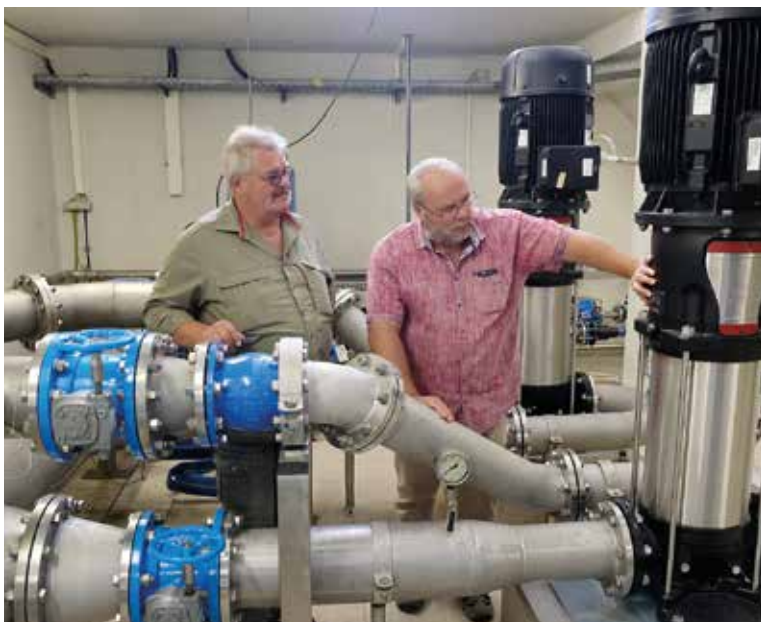
Inspektion der neuen DEA: links Dieter Schramm, Bereichsleiter Energie, Erzgebirge Trinkwasser GmbH rechts Ronald Weiher, Gebietsrepräsentant Grundfos GmbH
