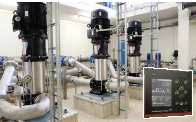
Die neue DEA mit 3 CR 125-4 Steuerung der Anlage erfolgt über Control MPC 3 x 45 kW. Alle relevanten Daten können über ein einfach zu bedienendes Display abgerufen werden
