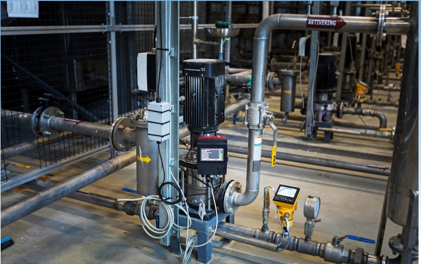
Une unité Grundfos de surveillance de l'état de fonctionnement fournit des données en temps réel à la fois au niveau de la pompe et au niveau du système SCADA central de BIRN.
