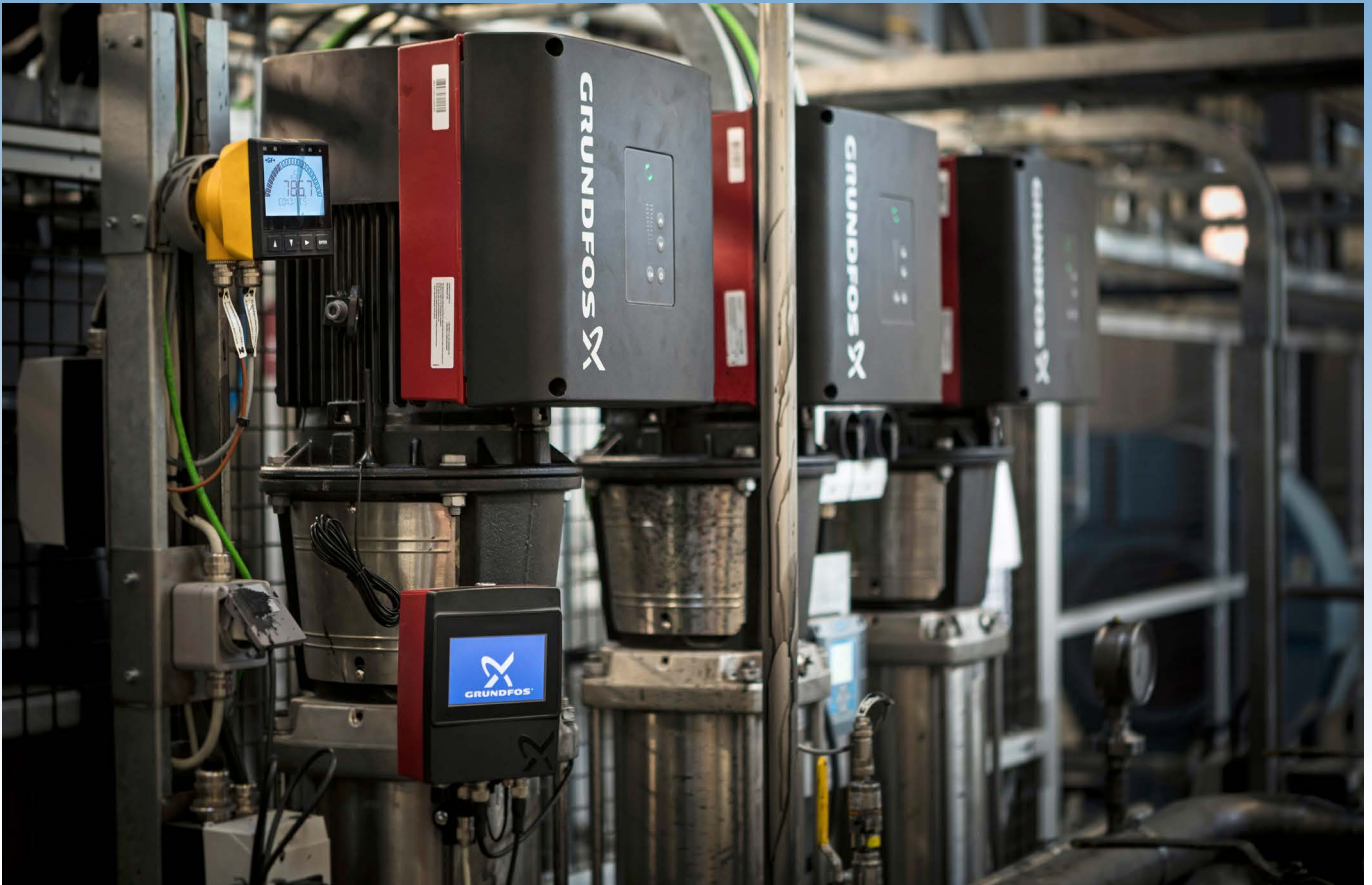
Les pompes Grundfos CRE et une unité de surveillance de l'état de fonctionnement équipent la cuve de peinture de l'usine de traitement de surface et de revêtement CED (« Cathode Electro Deposition ») de BIRN.
