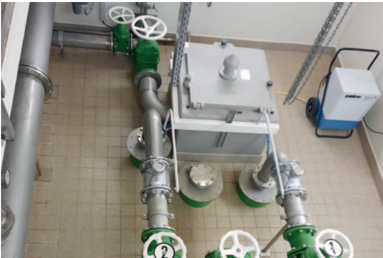
Im PW Apuhl wird das Rohwasser aus einer Quellfassung und 6 Tiefbrunnen gesammelt und zum Wasserwerk Hossengrund geleitet
