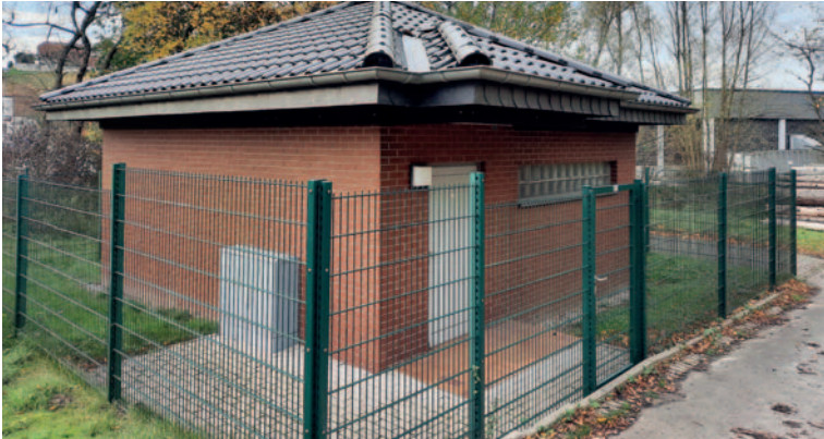
Pumpwerk Apuhl wird betrieben von den Wasserwerken Paderborn GmbH
