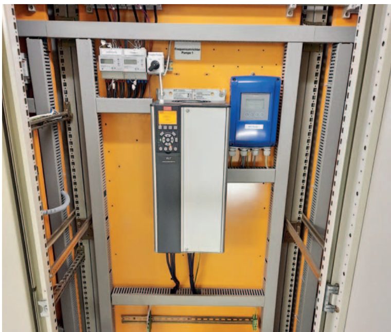
Die neuen SP Brunnenpumpen mit externem Frequenzumwandler
